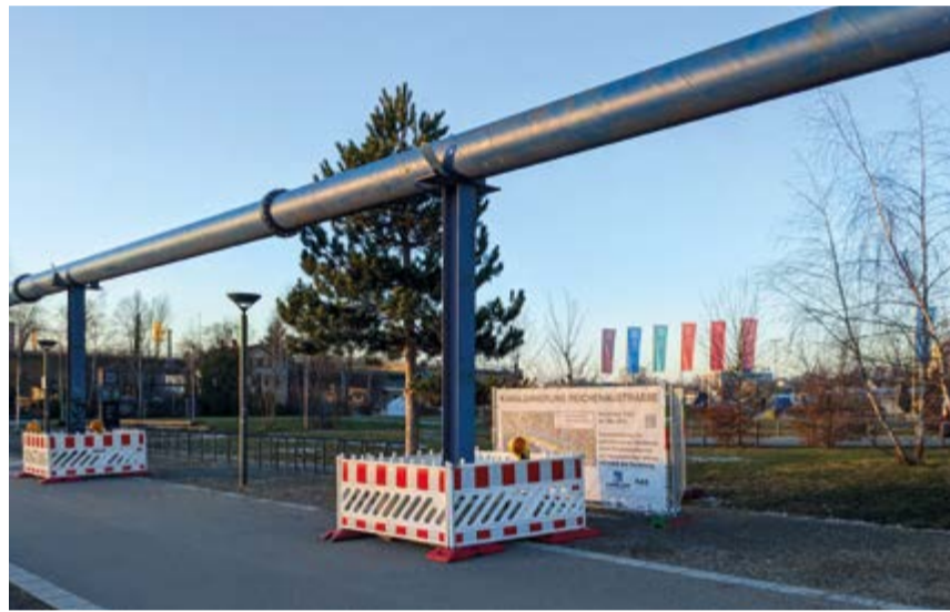
Die Abwasserleitung entlang des Seerheins ist mittlerweile in Betrieb.
