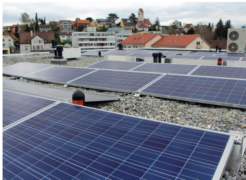
Photovoltaikanlage im Drechslerweg
